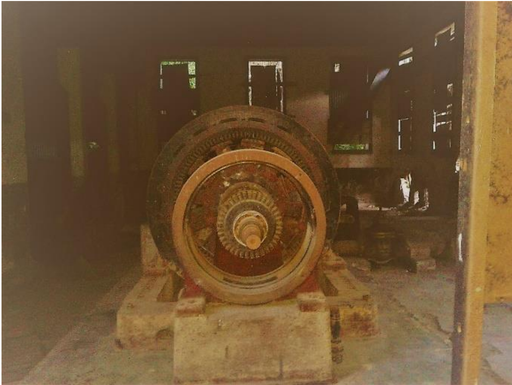
Ilustración 4 - Una de las turbinas. Foto en San Juancito, por Edgar David Cárcamo Cerrato.
